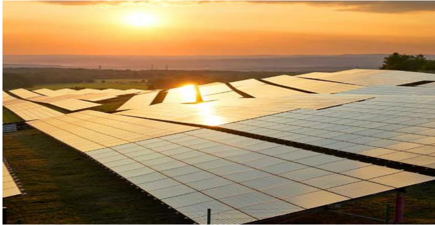
Imagen N°4, Sistema de paneles fotovoltaicos.
