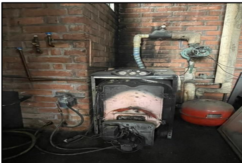
Imagen N°22, Estado actual Caldera Fer G3G 80.
