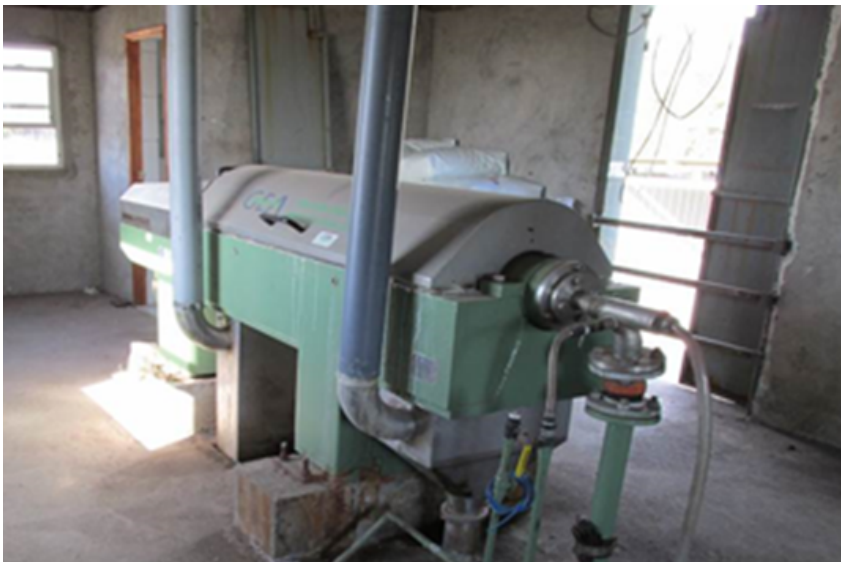
Figura 28: Unidad de deshidratación (Recuperado: Carreño. C, 2022).
