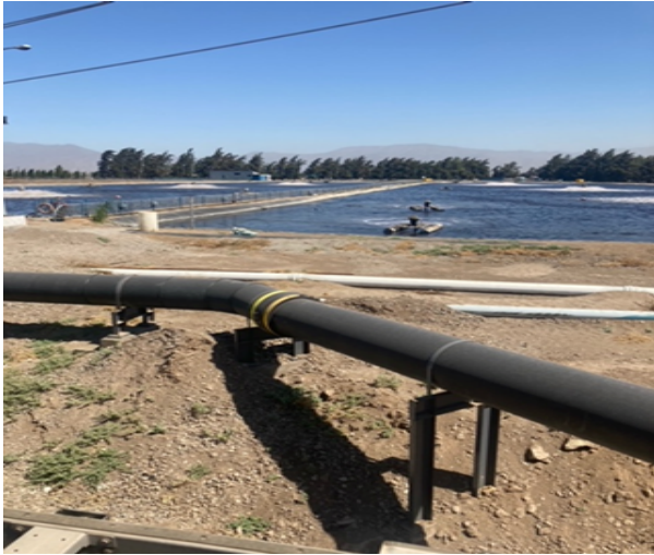
Figura 14: Ingreso a las lagunas aireadas. (Recuperado: Carreño. C, 2022)
