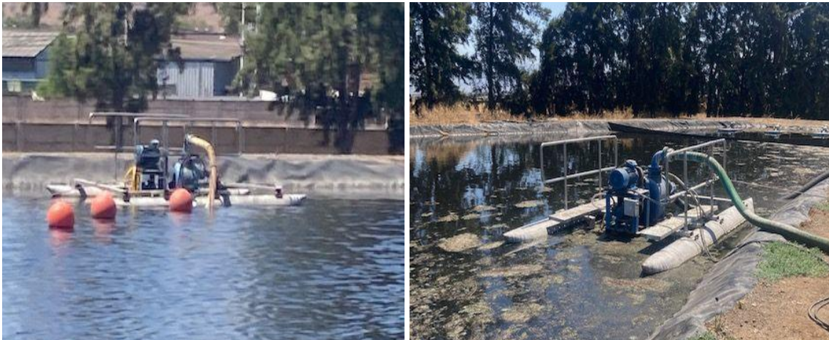
Figura 18 & 19: Bombas de succión de Lodos. (Recuperado: Carreño. C, 2022)
